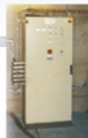
Rozváděč s řídicím a vyhodnocovacím systémem
